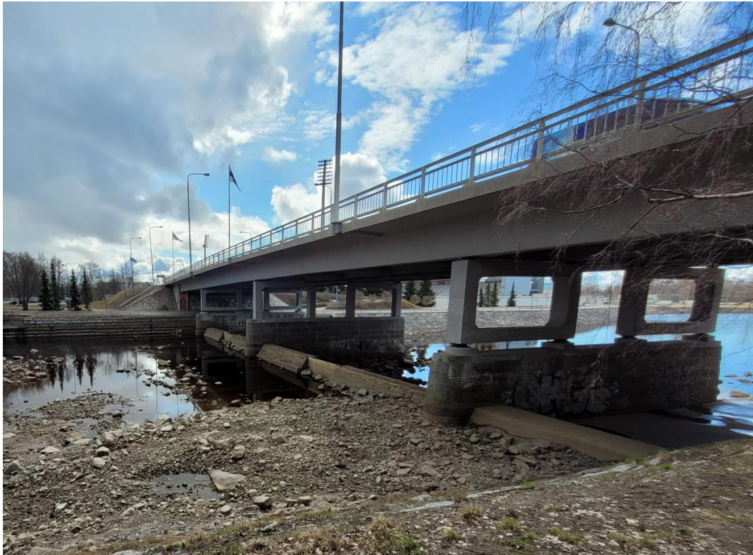
Kuva 12. Tuiranväylän pohjapadot ovat nykytilaisena nousueste vaelluskaloille ja lisääntymisalueen toteutusvaiheessa ne on joko purettava tai saatava toimimaan nousuyhteytenä alueelle.
